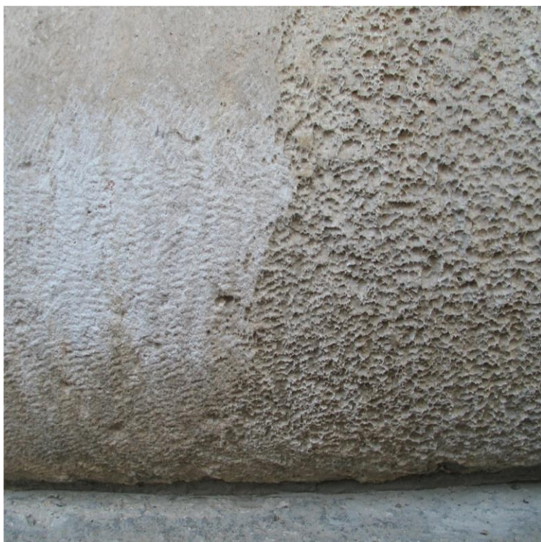
Sl. 99. Detalj površine na kojoj je sačuvan izvorni trag alata-marteline i gradine i detalj površine koja je erodirana kišom, Friz, Peristil, fotografija: Vinka Marinković
