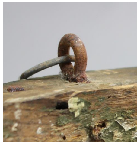
Slika 59 Korodirana kukica za vješanje, detalj
