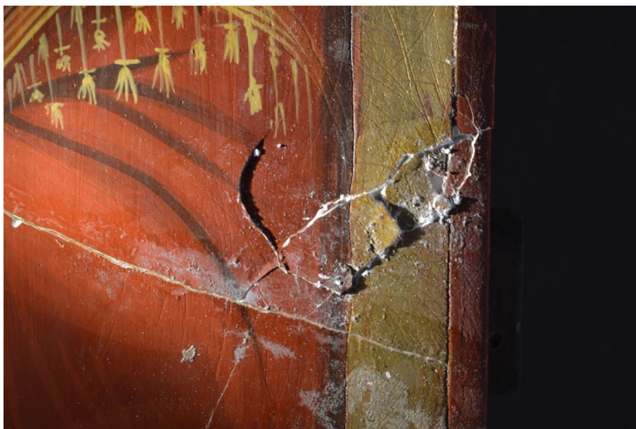
Slika 10 Detalj oštećenja s nepravilno zalijepljenim komadićima slikanog sloja
