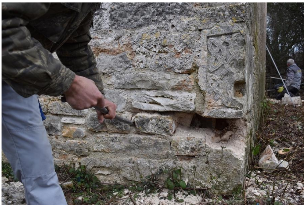
Slika 129. Razgradnja zidane pozicije – za ugradnju replike imposta s prikazom sirene, fotografija: Martin Zohil
