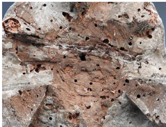
Slika 14. Crvotočinom oštećeno podnožje baze
