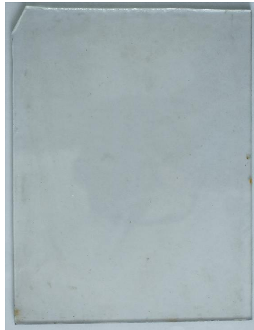
Slika 36 Zatečeno stanje, staklo, desni okvir
