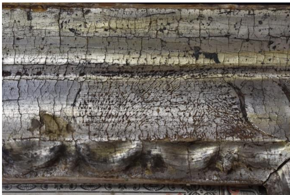
Slika 30 Desni okvir, zatečeno stanje, detalj, krakelire
