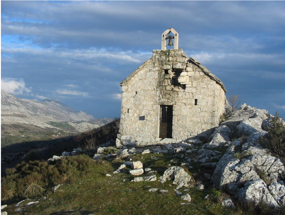
Slika 47 Crkva svetog Maksima u Jesenicama prije obnove. Preuzeto sa: https://smn.hr/jesenice (pristupljeno 29.1.2019.)
