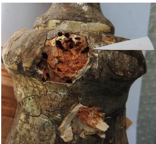
Slika 61. Mjesto na kojem nedostaje drveni nosioc zbog visokog stupnja biološkog oštećenja
