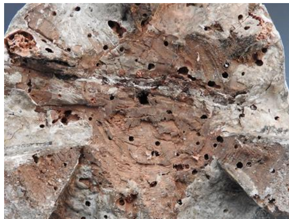
Slika 14. Crvotočinom oštećeno podnožje baze
