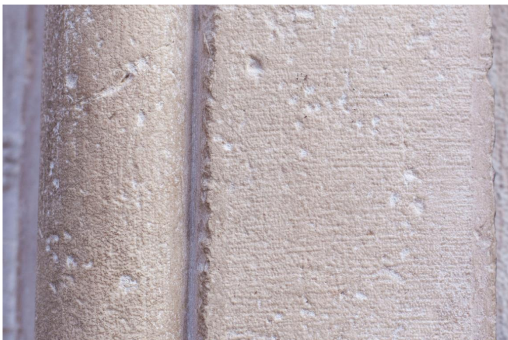
Sl. 113. Fina obrada martelinom, površina je erodirana, Velika Papalićeva palača, Split, 16. st., fotografija: Josipa Krolo
