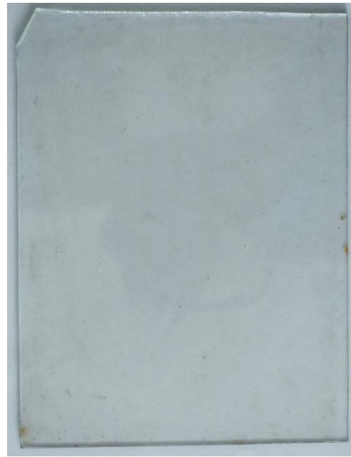
Slika 36 Zatečeno stanje, staklo, desni okvir
