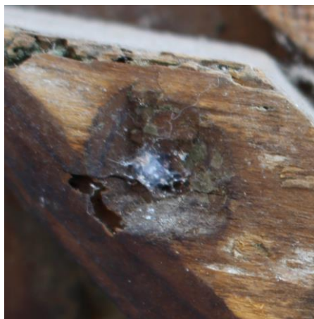
Slika 60 Oštećenje i diskoloracija nastali zbog djelovanja korozije na okolno drvo - donja konstruktivna letvica, detalj
