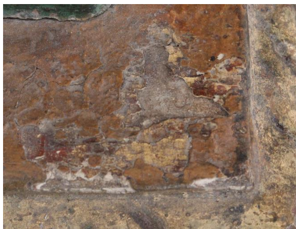
Slika 55: Oštećenja preslika na gornjoj stranici većeg postamenta, detalj
