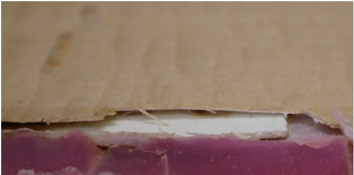
Slika 22 Detalj gdje je vidljivo odvajanje dvaju slojeva osnove
