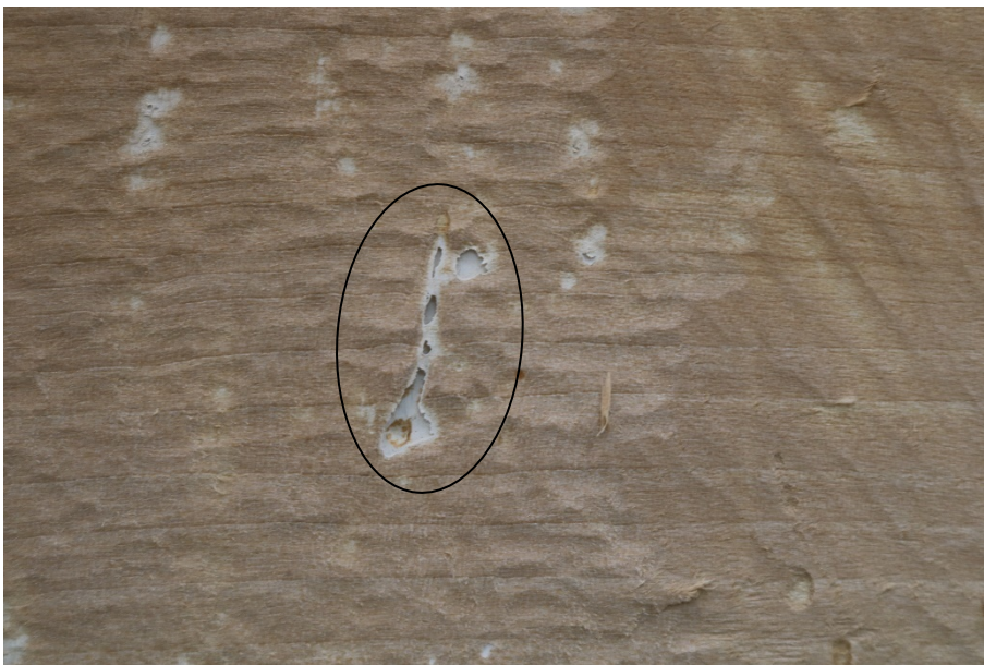
Slika 23 Detalj gdje je vidljivo odvajanje nositelja zajedno s prvim slojem osnove od drugog sloja osnove
