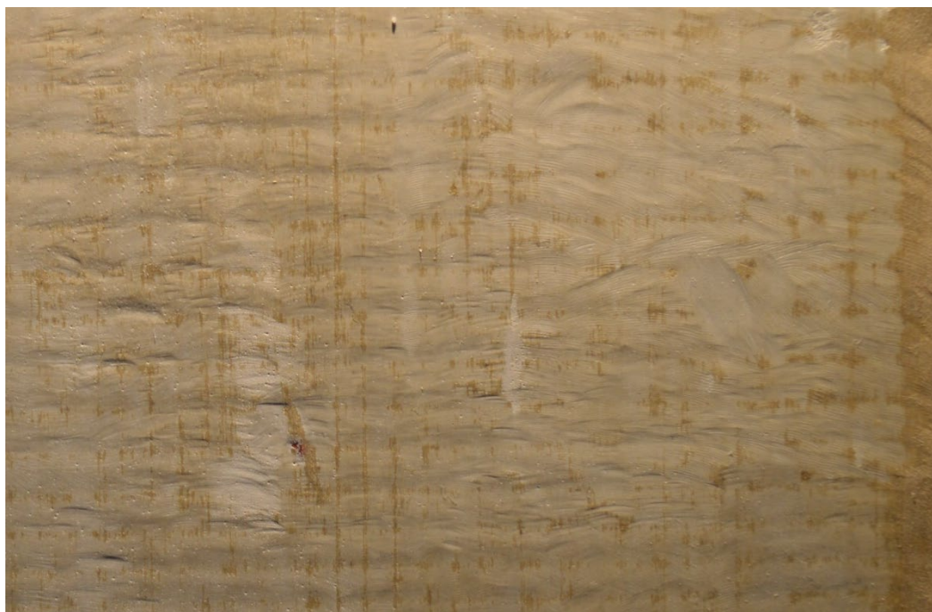
Slika 100 Oštećenja u osnovi i tragovi tanjurastog nastavka
