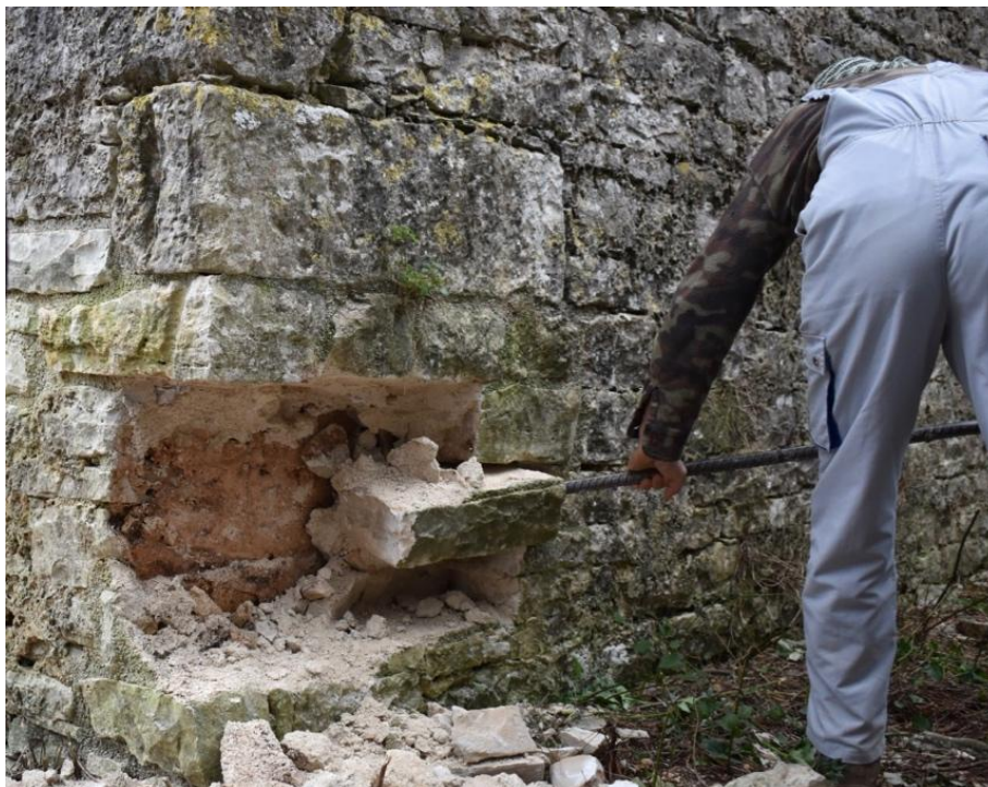
Slika 128. Razgradnja zidane pozicije – za ugradnju replike ulomaka nepoznate namjene, fotografija: Martin Zohil
